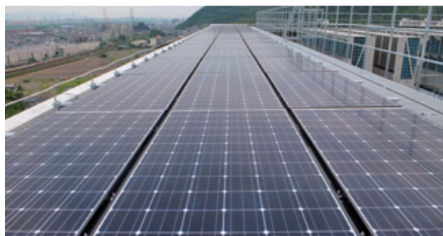
水無瀬研究所 太陽光発電パネル
